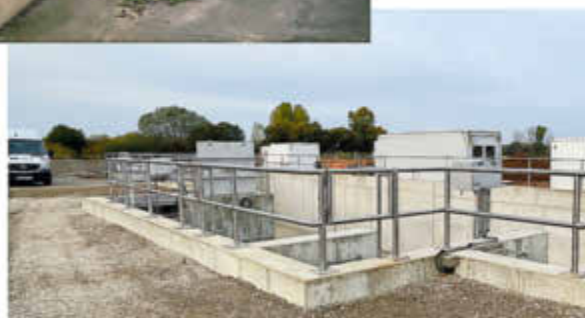
oben: Das alte RÜB musste zuletzt sogar gestützt werden. unten: Das neue, modern ausgestattete RÜB ist nun in Betrieb.
